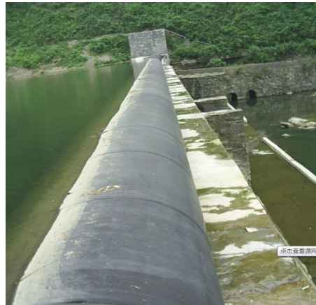
橡胶坝水位监测
